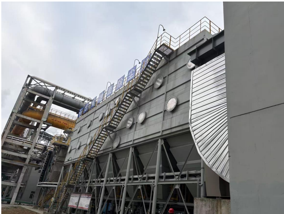
干熄焦地面除尘站
