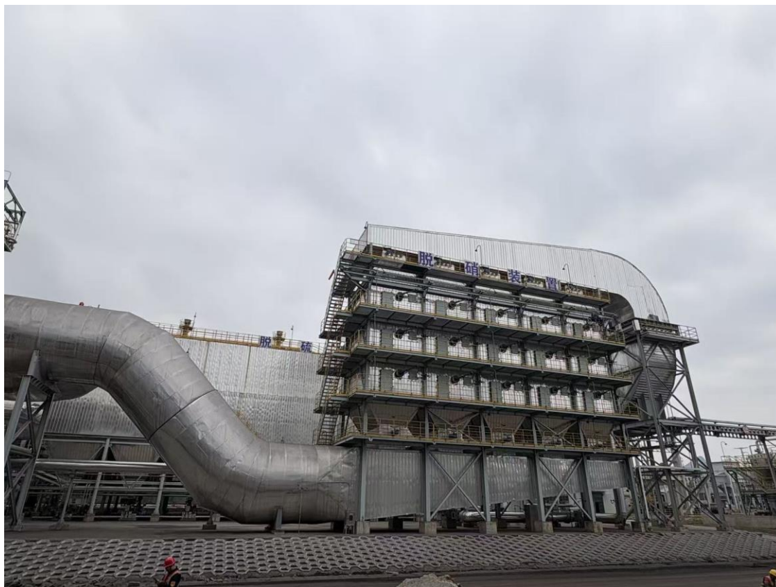
焦炉烟气脱硫脱硝除尘装置
