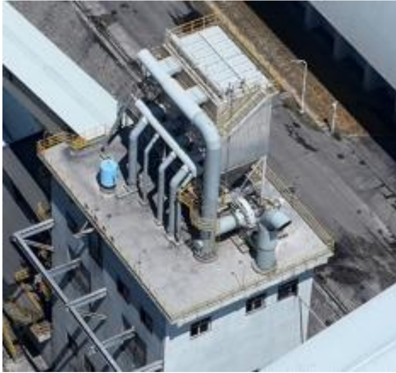
精煤粉碎除尘设施
