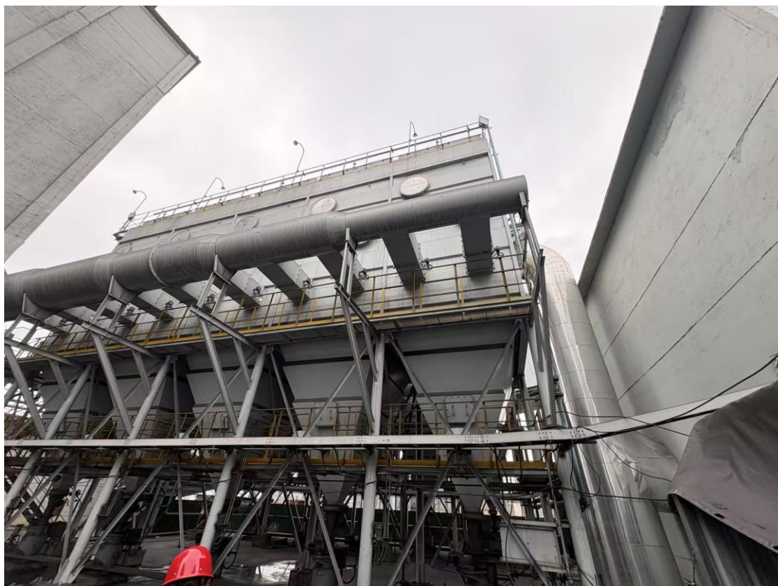
筛贮焦楼除尘设施
