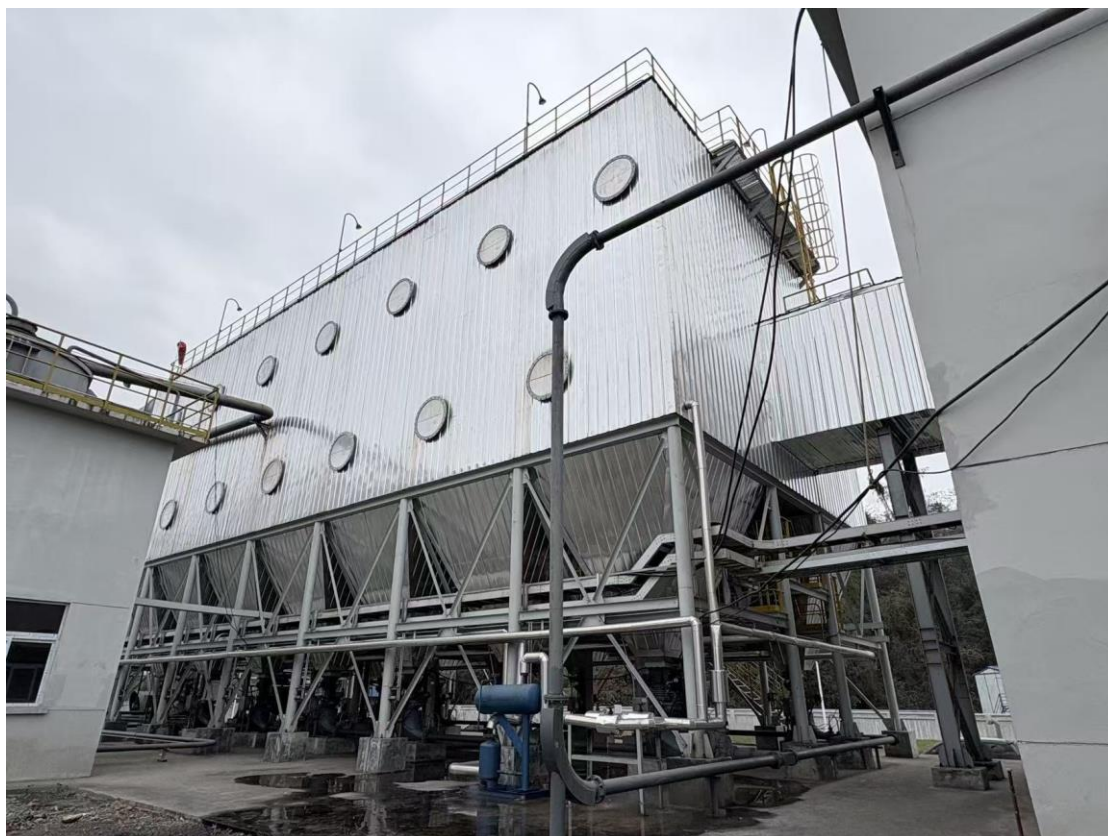
焦炉机侧地面除尘站
